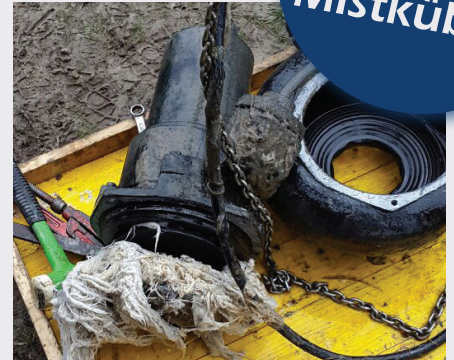
Diese verstopfte Kanalpumpe musste in Gollarn von den Mitarbeitern des GAV ausgebaut und instandgesetzt werden.
